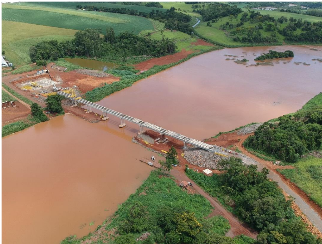
Figura 10-7 - Acesso à ponte pela margem direita, com acesso já existente (em obra).
